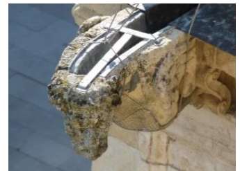
Fig. 14. Gárgola con barras de sujeción y alambres
