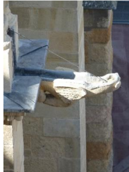
Fig. 10. Gárgola sujeta con alambre y revestimiento
